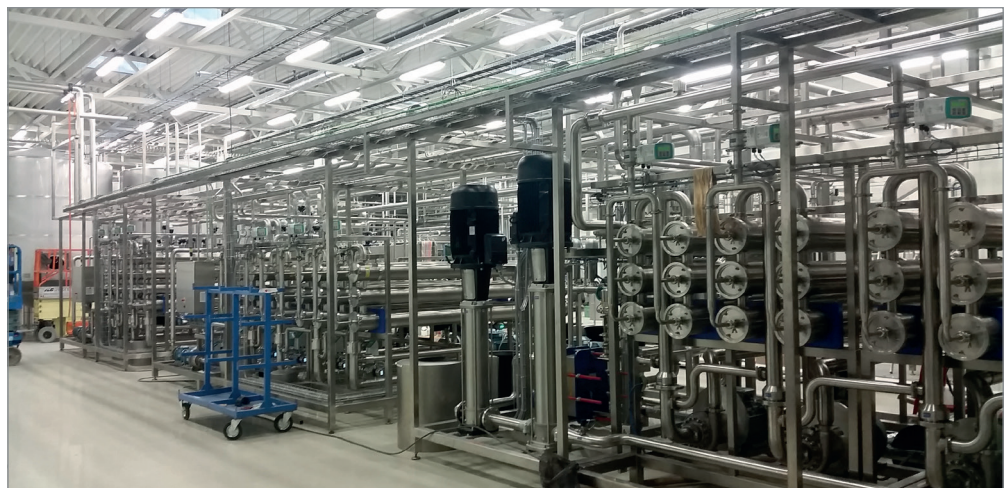
La nueva planta de filtración
