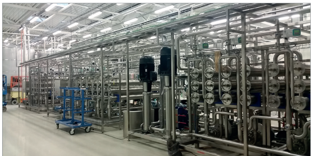
Die neue Filtrationsanlage
